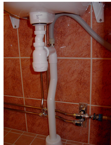
Anslutning av vatten & avlopp till tvättmaskin
